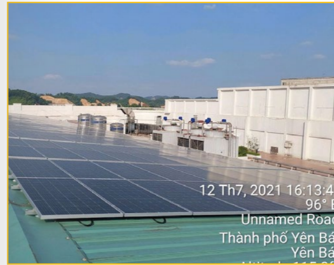
EPC DA TTTM VINCOM PLAZA YÊN BÁI 128KWP
