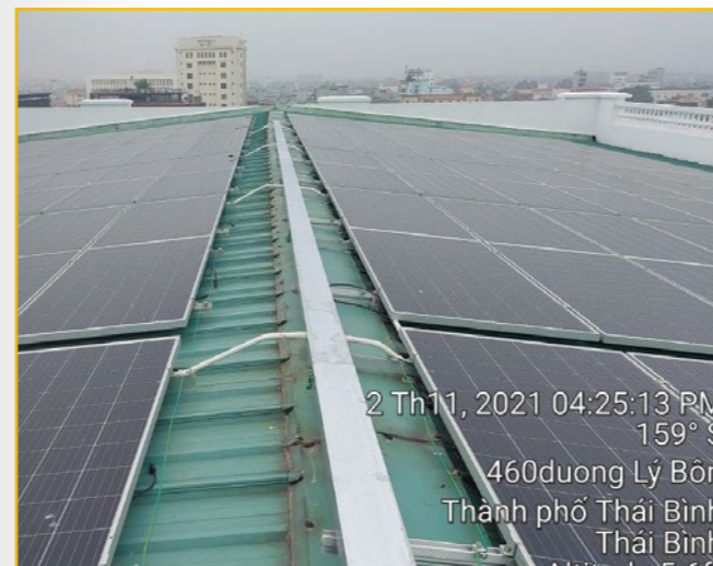
EPC DA TTTM VINCOM PLAZA THÁI BÌNH 213,6 KWP
