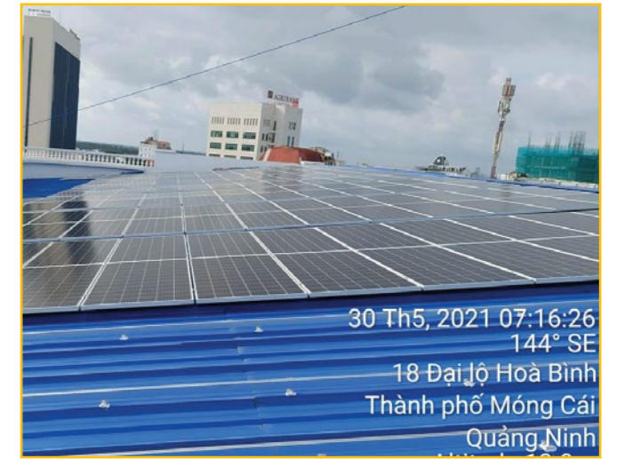
EPC DA TTTM VINCOM PLAZA MÓNG CÁI 188 KWP
