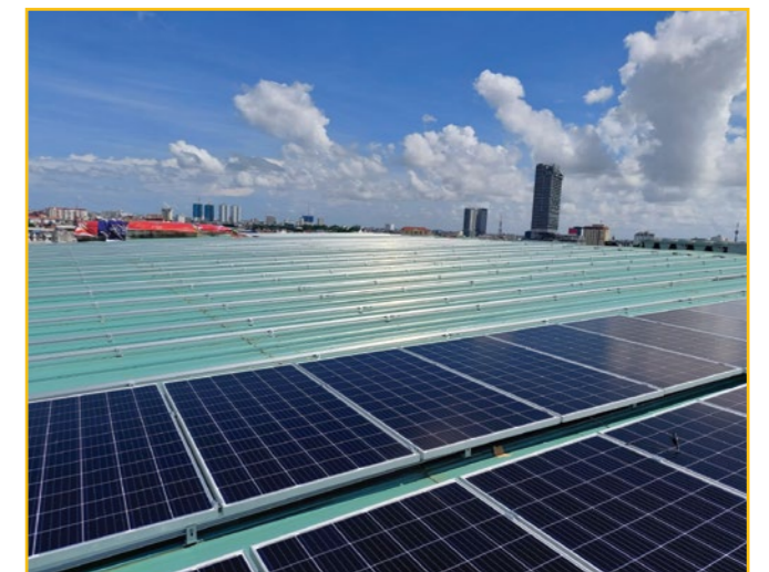
EPC DA TTTM VINCOM PLAZA HẢI PHÒNG 192KWP
